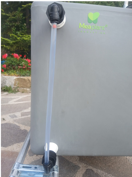
Sistema per il controllo del livello dell'acqua nella vasca.
